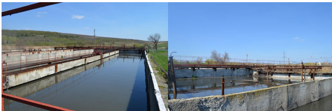
Figura 4-17: Stația de epurare. Bazin de aerare cu nămol activ. Decantoare secundare
