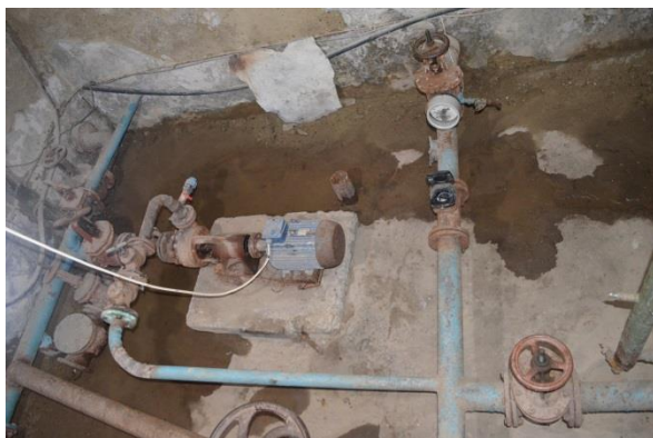
Figura 4-5: Stația de pompare a apei SP-4
