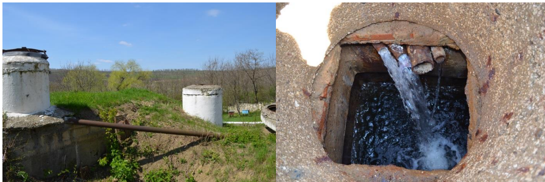
Figura 4-6: Rezervor subteran de apă cu volumul 250 m 34
