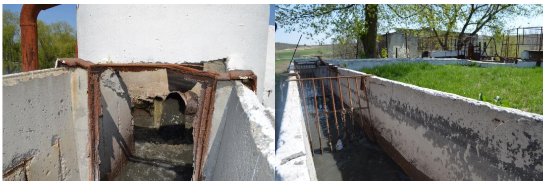
Figura 4-15: Stația de epurare a apelor uzate. Disipator de energie. Grătare
