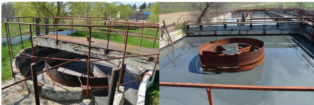
Figura 4-16: Stația de epurare a apelor uzate. Deznisipator orizontal. Decantor primar
